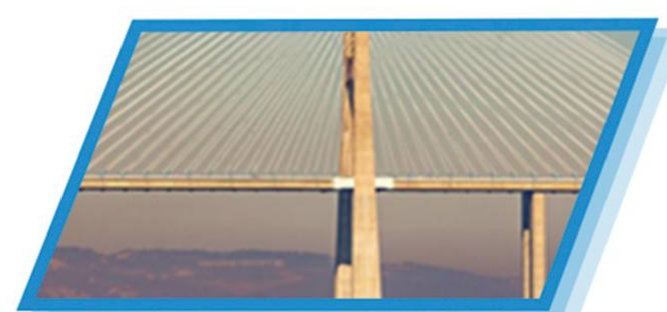
桥梁施工及运营期健康监测
